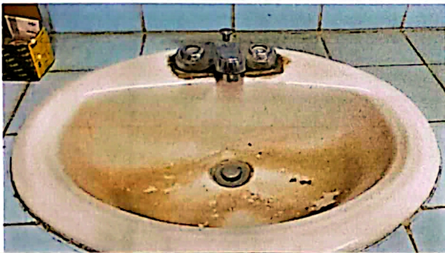
Foto 9: Lavamanos en mal estado, la llave y tubería no sirven.
