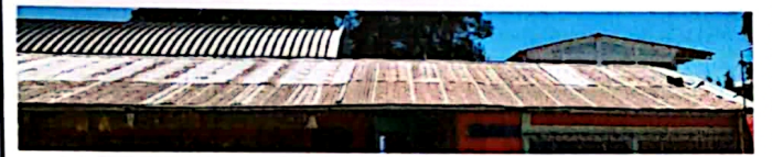
Foto 1: laminas en mal estado, techo y pared
