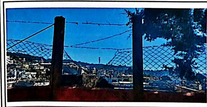
Foto 5: Malla en mal estado en todo el establecimiento.
