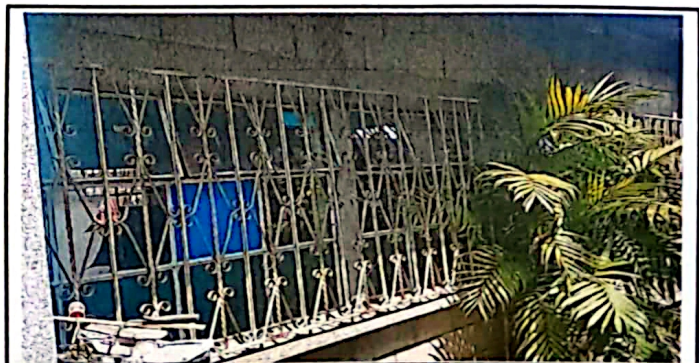
Foto 6: Balcones en mal estado y oxidados
