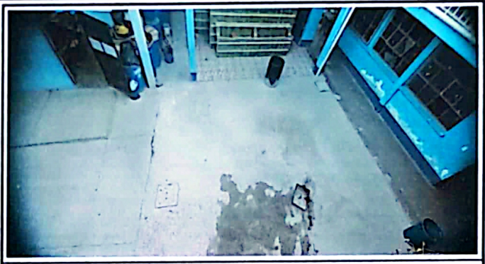
Foto 2: El patio cívico necesita mantenimiento
