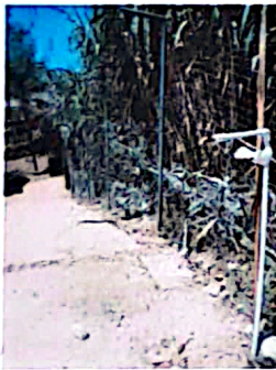
Foto 3: Malla perimetral en mal estado
