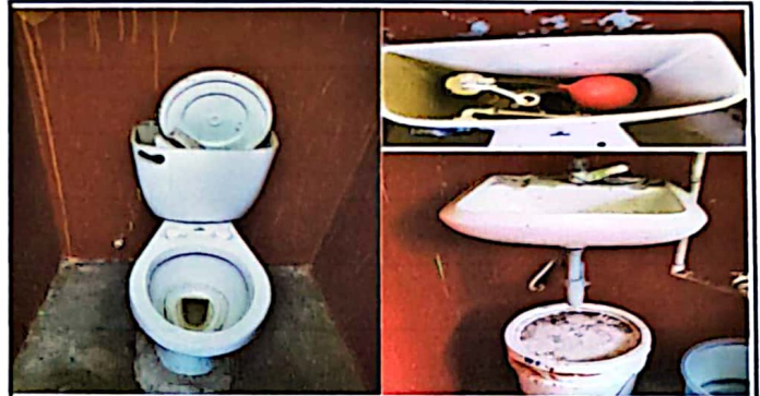
Foto 2: Inodoros y lava manos en mal estado.
