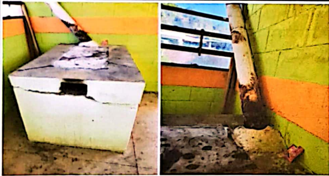
Foto 3: Plancha de cocina en mal estado, chimenea a punto de caerse.
