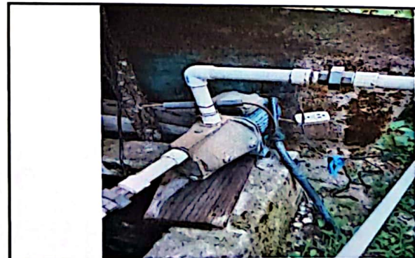
Foto 6: Bomba de agua en mal estado, necesitamos una bomba sumergible nuevo para llenar depósito de agua, porque para tener servicios sanitarios en buen estado se necesita agua.
