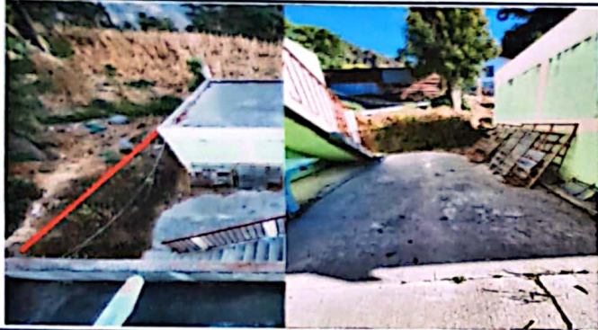
Foto 1: Espacio no circulado con block, se desliza tierra. Medida de 5.5 Mts de largo y 3 Mts de altura.
