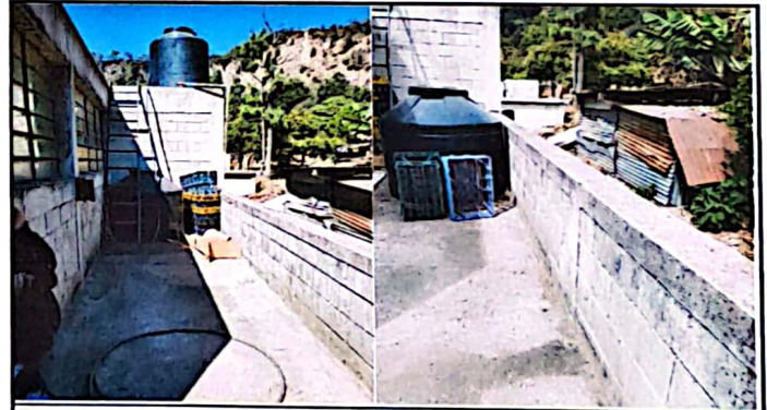
Foto 4: Techado de bodega con lámina y terminación de pared con lámina. Sirve para guardar materiales que pertenece a la escuela.
