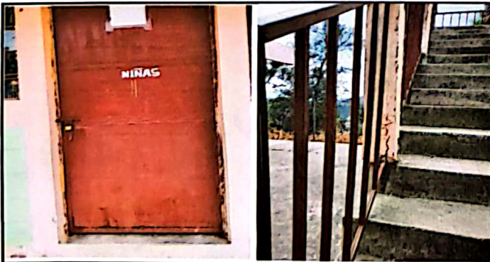
Foto 5: Puertas y barandas oxidado.
