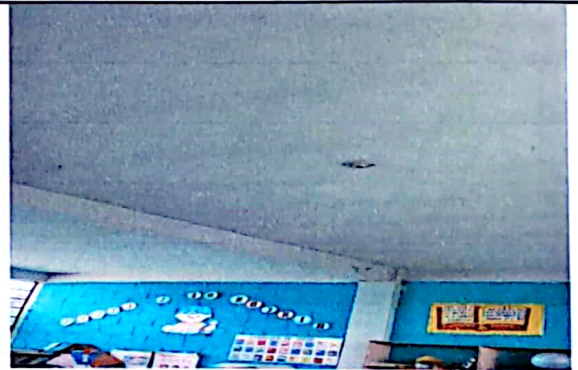
foto 4: sistema electrico en malas condiciones
