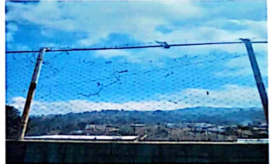
foto 2: Cerco o malla en malas condiciones
