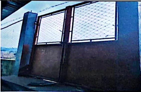
foto 3: porton en malas condiciones
