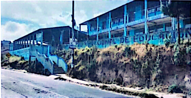
foto 1: pintura en mal estado de la escuela
