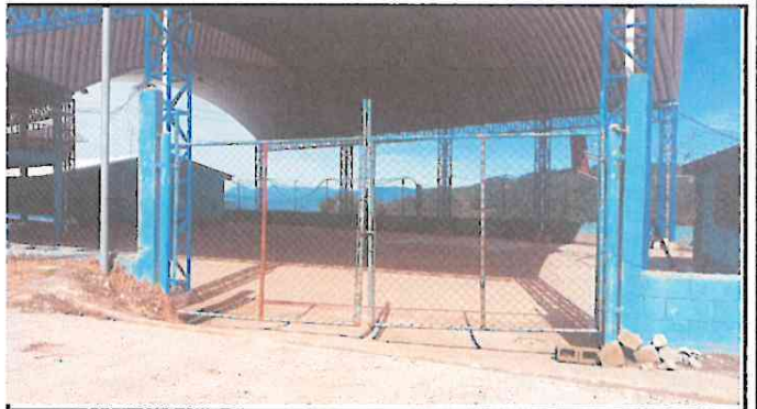
Foto 4: portón sin seguridad.
