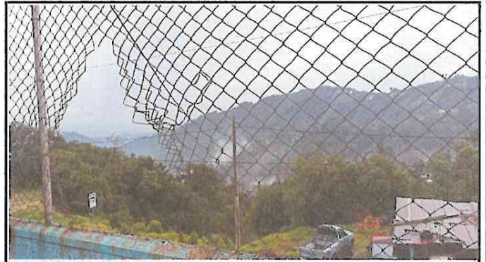
Foto 2: Muro perimetral en malas condiciones.
