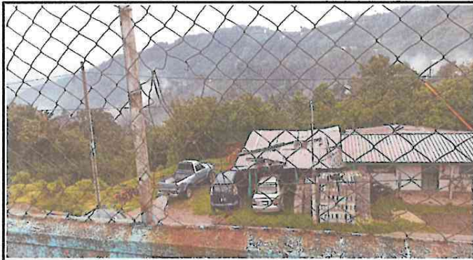
Foto 1: Malla en mal estado.
