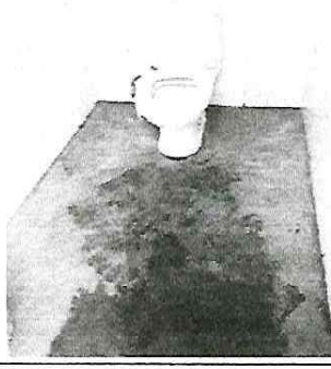
Foto 3: Servicios Sanitarios y sus accesorios
