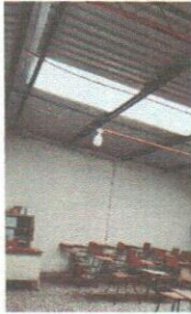
Foto 3: Mejoramiento de techado de aulas, sistema eléctrico y pintura en muros internos, en modulo de aulas 1.
