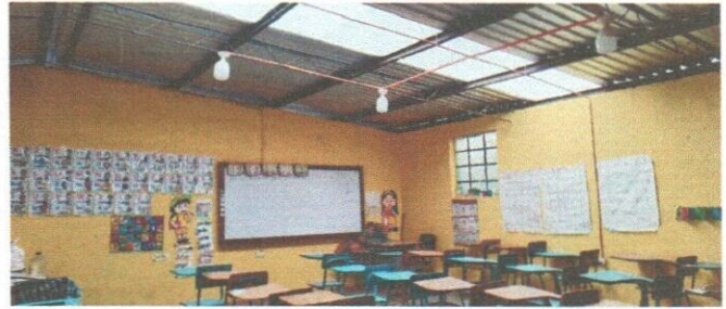
Foto 2: Mejoramiento de techado de aulas, sistema eléctrico y pintura en muros internos, en modulo de aulas 1.
