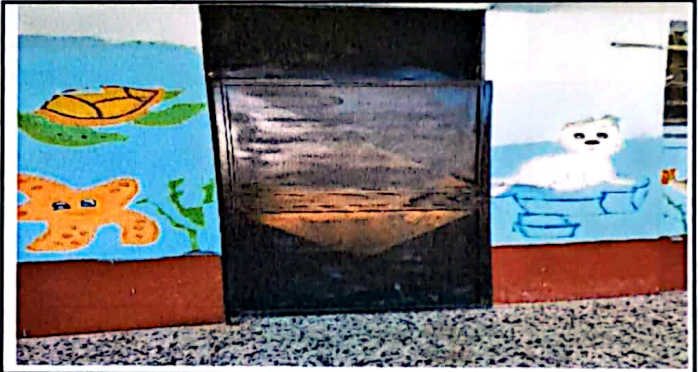
FOTO 4: Puertas y chapas en mal estado.
