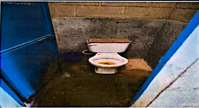
FOTO 3: Inodoro en malas condiciones.
