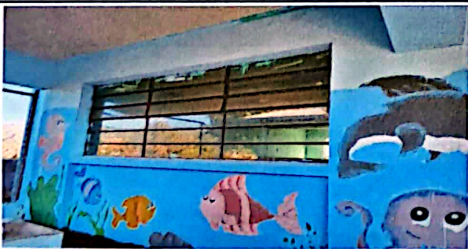
FOTO 5: Barrandas en malas condiciones.
