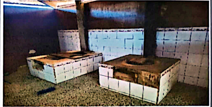
FOTO 2: Estufas de leña en malas condiciones.
