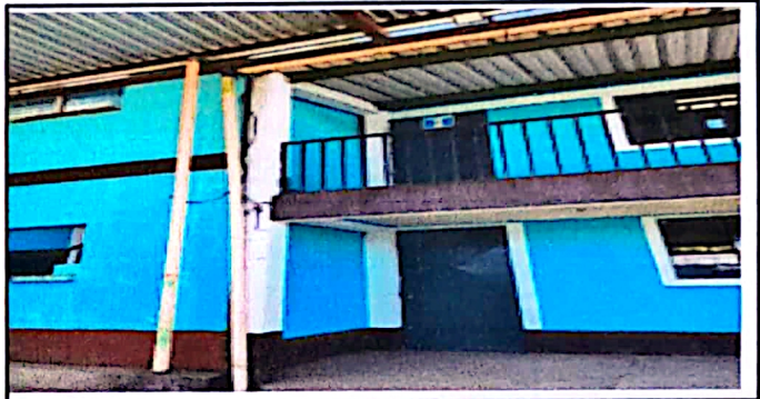
Fto 2 barandas en mal estado.
