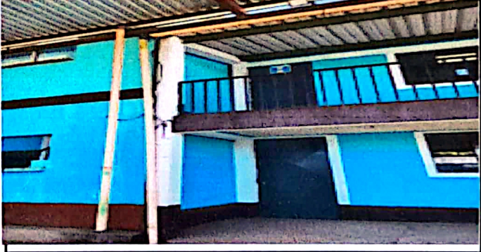
Foto 4 canales en mal estado
