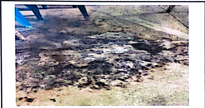
Foto 1 piso en el aula en mal estado.
