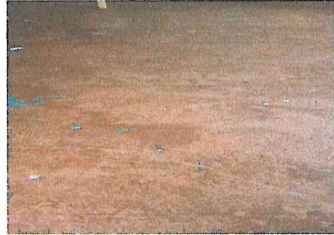
Foto:2 piso de cocina en mal estado
