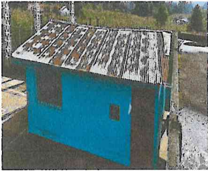
Foto:1 Techo de cocina en mal estado
