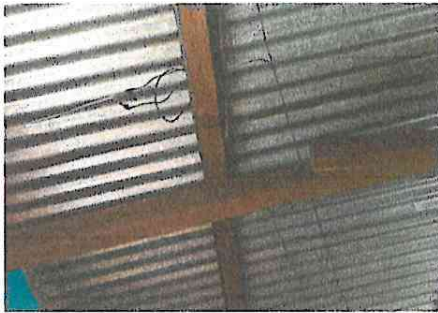
Foto:3 Alambres de cocina en mal estado
