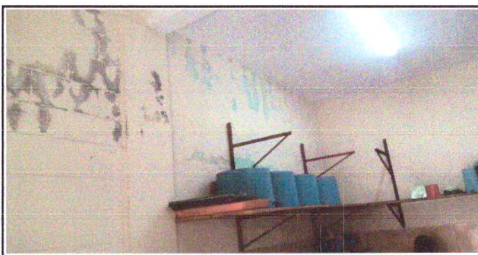
Foto 6: Todo el largo del muro de cocina se encuentra humedo del lado de la colindancia con preprimaria
