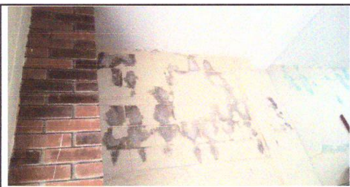
Foto 5: Humedades en muro de cocina, area con cubierta de losa de concreto
