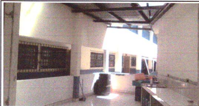
Foto 1: Imagen desde el interior del area de cocina en primer nivel, se pueden apreciar 03 areas donde se instalará ventanería y se realizará prolongación de la cubierta de metal
