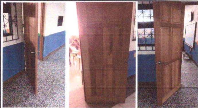
Foto 9: Puertas que abaten hacia fuera, no cumplen el estándar de la NORMA NRD-2 y provocan topes de circulación en pasillos. Se modificará la forma del abatimiento.
