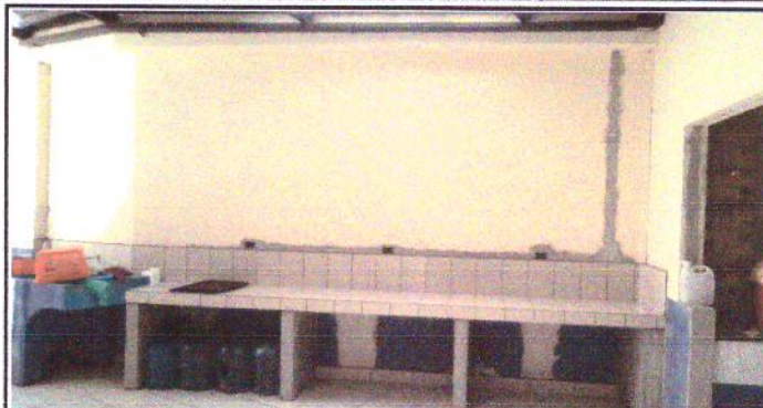
Foto 2: Foto del top de cocina al cual solo se trabajo la tubería y accesorios para instalaciones electricas y no fueron habilitadas. Estos trabajos serán realizados por medio del mantenimiento
