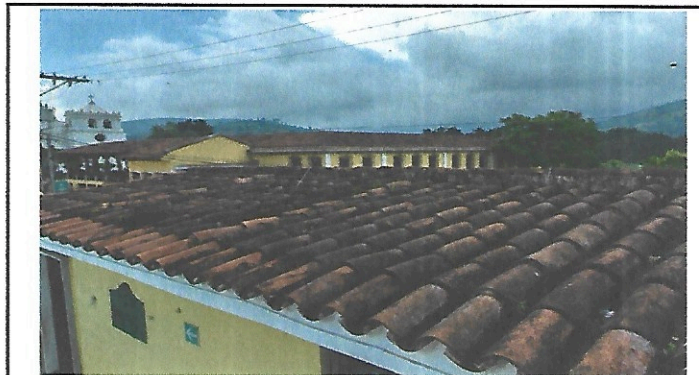
Foto 4: Estado actual de tejado de salón de computación
