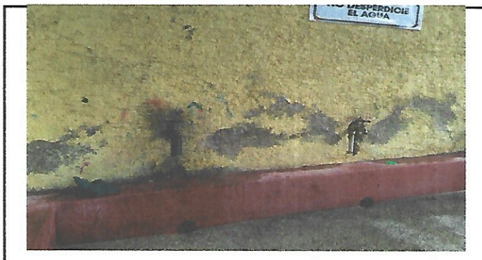
Foto 6: Estado actual de pintura en el establecimiento
