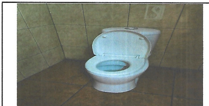
Foto 6: Estado de sanitarios planta baja
