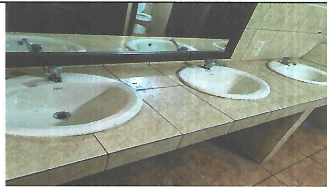
Foto 4: Estado actual de lavamanos planta baja.
