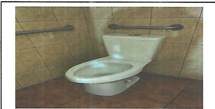
Foto 5: Estado actual de sanitarios planta baja
