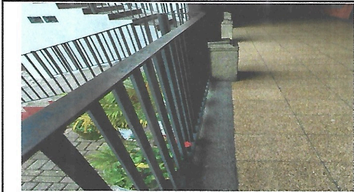
Foto 1: Estado actual de barandas de los pasillos que se encuentran con corrosión
