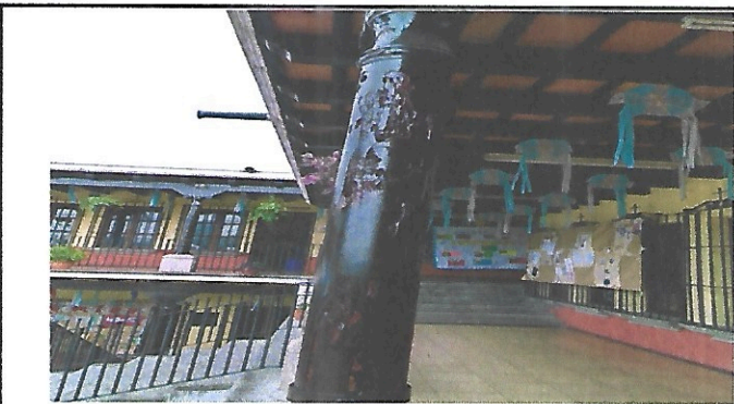
Foto 5: Estado actual de columnas planta alta 2
