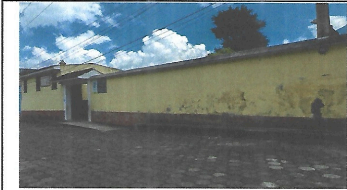
Foto 1: Estado actual de pintura de fachada principal
