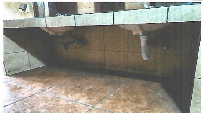
Foto 2: Estado actual de lavamanos planta baja
