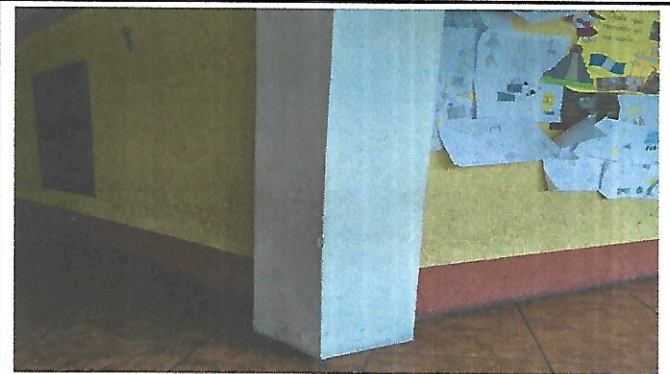
Foto 2: Estado actual de pintura en columnas pasillo de la preprimaria
