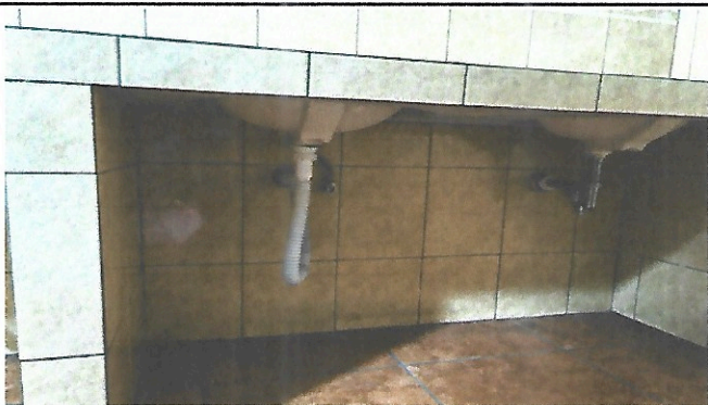
Foto 3: Estado actual de lavamanos planta baja
