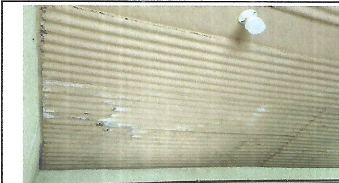
Foto 3: Estado actual de salón techo de salón de computación
