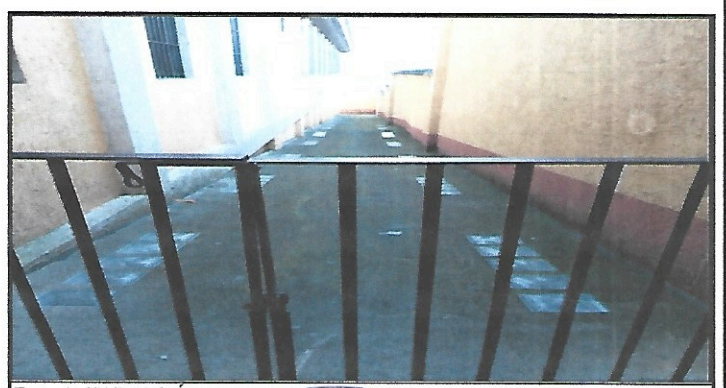
Foto 6: FILTRACIÓN DE RAMPA
