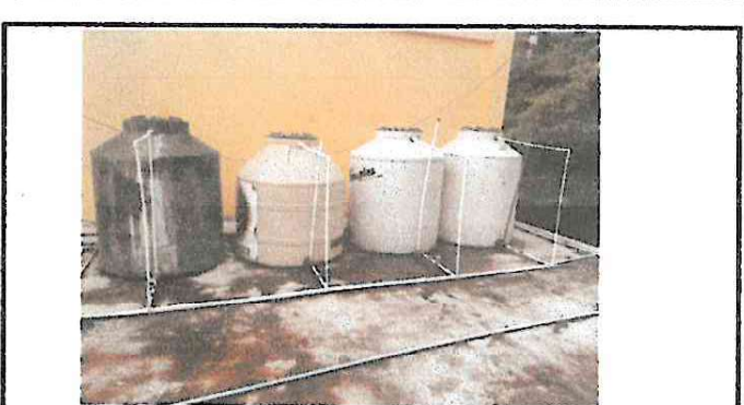
Foto 6: Módulo C- Agua potable: Depósitos de agua potable en mal estado.
