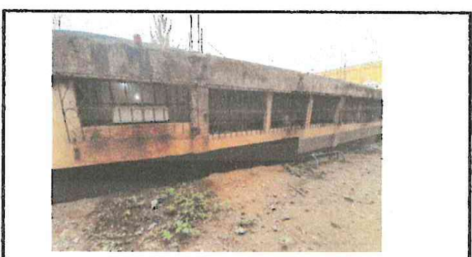
Foto 4: Módulo B- Aulas: parte posterior al módulo en mal estado sin recubrimiento a causa de la lluvia y al nivel del terreno.
