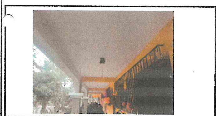
Foto 5: Módulo B- Aulas: Poca iluminación y falta de tomacorrientes dentro y fuera del aula.
