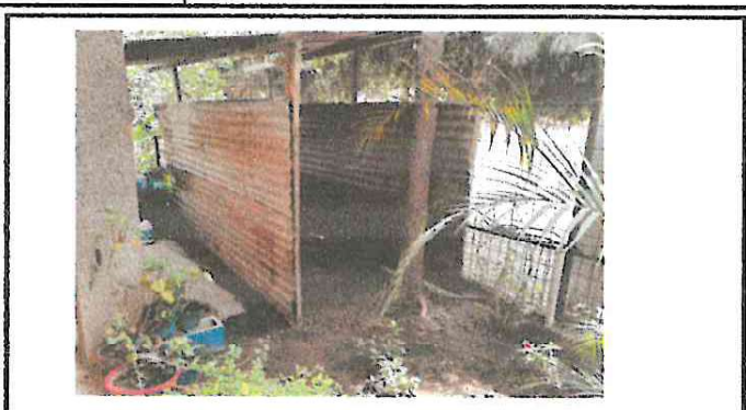
Foto 2: Módulo A - Sanitarios. Los sanitarios de preprimaria se tuvieron que deshabilitar preveendo el colapso de la galera.
