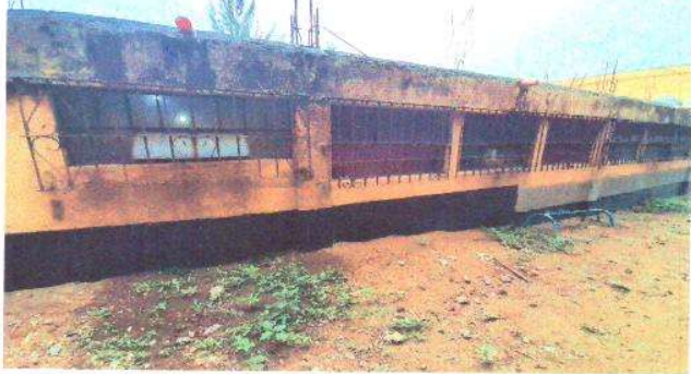
Foto 1: Módulo A - Fachada posterior del edificio en mal estado
