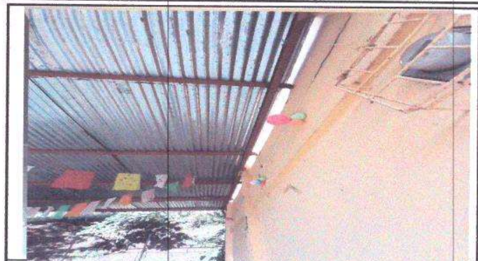
Foto 9: Módulo H- Galera: Filtración de agua de lluvia.
