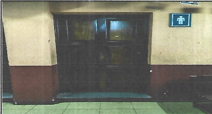
Foto 3: reparación de puertas en los sanitarios de hombres, del primer y segundo nivel.
