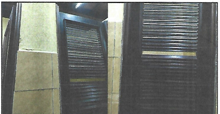
Foto 6: reparación de puertas de los sanitarios de la planta alta y planta baja
