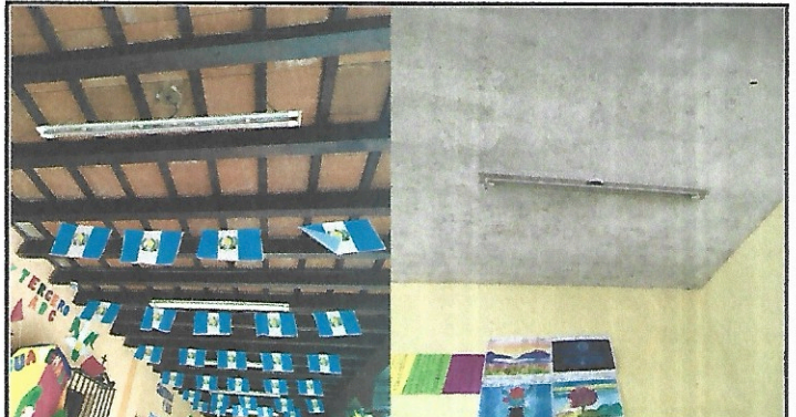
Foto 4: corredor de la planta baja, y salón de 2A en donde los gasneones están en mal estado
