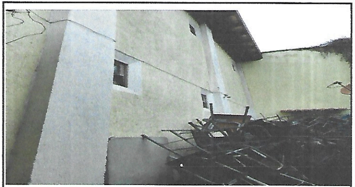
Foto 2: reparación de una de las paredes de la cocina, que necesita reparación
