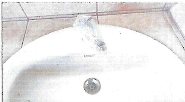
Foto 4: lavamanos y chorros en malas condiciones
