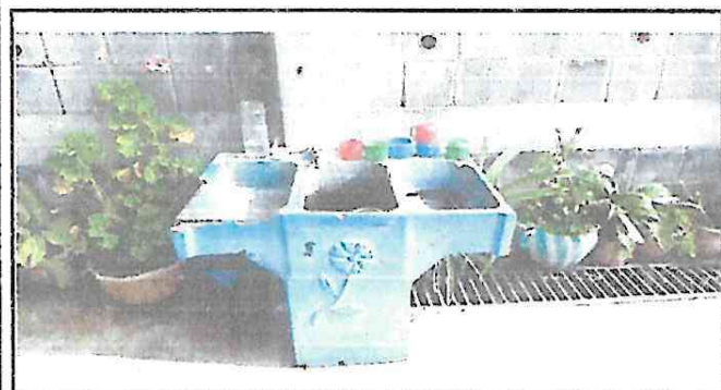
Foto 3: pila, tubería y drenaje en malas condiciones
