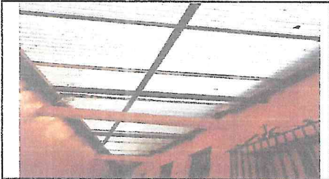
Foto 1: techo en mal estado
