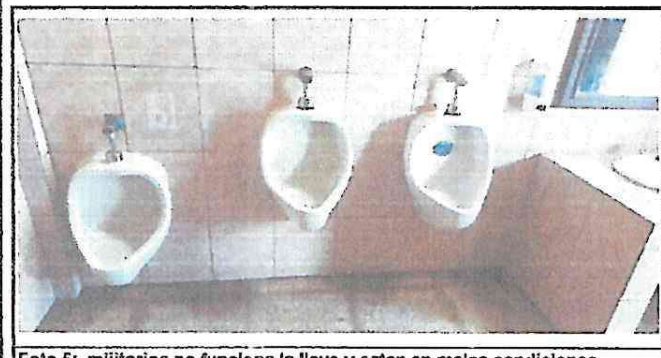
Foto 5: mijitorios no funciona la llave y estan en malas condiciones
