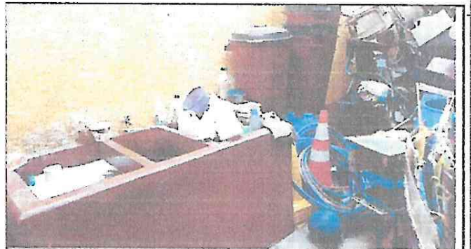
Foto 4: ambiente para crear una cocina, actualmente en mal estado.
