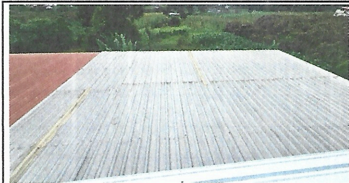
Foto 3: Estado de lámina con agujeros y remiendo del salón derecho del módulo del segundo nivel.
