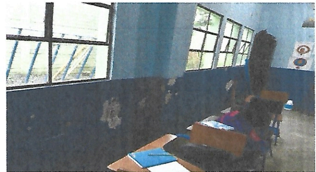
Foto 4: Estado actual de la pintura que esta afectado por la humedad del primer módulo por humedad.
