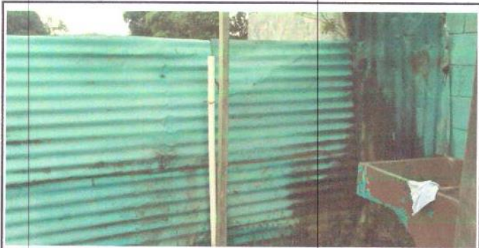
FOTO 5: MURO PERIMETRAL PARTE ESTE PEGADO A LA PILA Y BAÑOS
