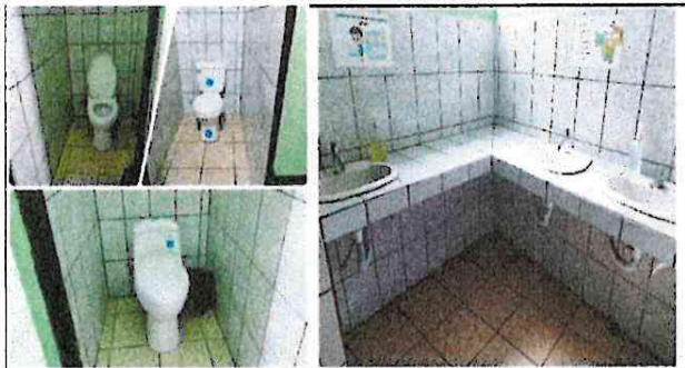
Foto 3: MEJORAMIENTO Y MANTENIMIENTO DE SERVICIOS SANITARIOS Y CAMBIO DE SUMINISTROS EN LAVAMANOS
