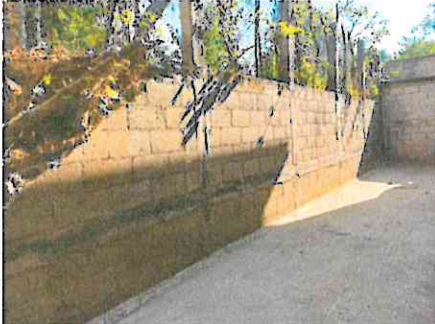
Foto 1: Vista general de muro, esquina superior izquierda muro dañado por deslave.
