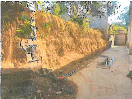
Foto 3: Vista del área donde se debe reponer muro
