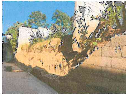
Foto 4: Se evidencia el daño al muro
