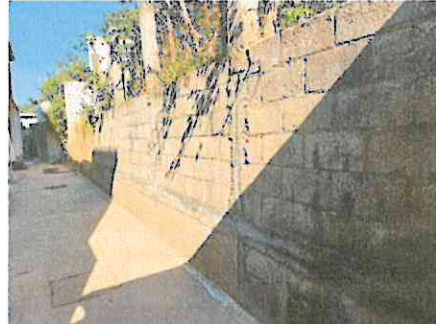
Foto 2: Vista general muro dañado, el cual es necesario reponer para evitar daños a la infraestructura y a la población estudiantil.
