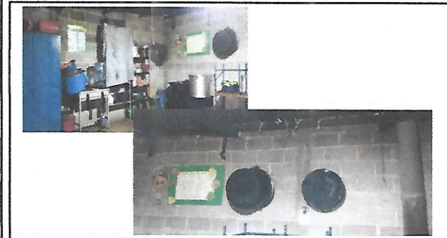
Foto 1: El módulo de la cocina es donde se necesita la mayor inversión, se debe de subir el nivel del techo, cambiar algunas laminas que presentan goteras, repello de parederes, colocación de piso y azulejo.
