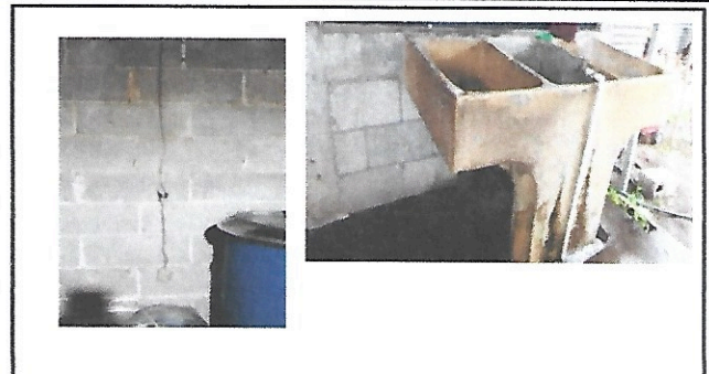
Foto 2: La pila de la cocina debe ser sustituida por otra nueva o remozarla, el sistema electrico debe ser la mejor,
