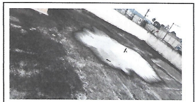
Foto 4: Es necesario, ipermealizar la loza del segundo nivel y colocar bajadas de aguas pluviales y evitar nuevamente que el agua se acumule y filtre.
