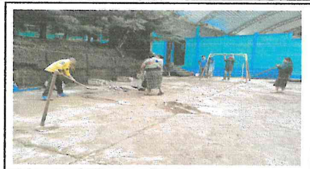
Foto 2: Foto1: Muro Perimetral colapsado (Área de trabajo 1)
