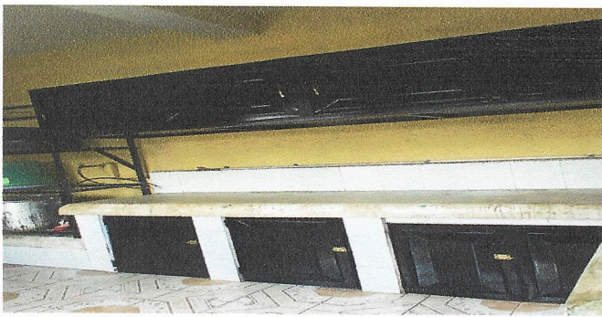
Foto 3: Instalación de bavinetes aereos y puertas para gavinete.
