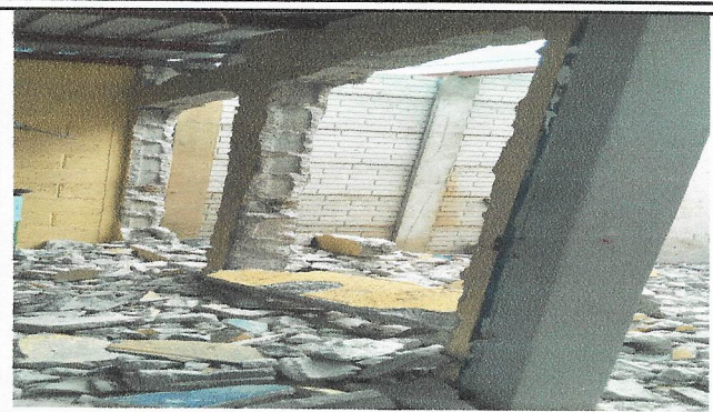
Foto 2: Pared derrumbada para ampliar salón
