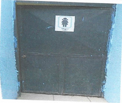
Foto 1: Puertas de salones y sanitarios dañados
