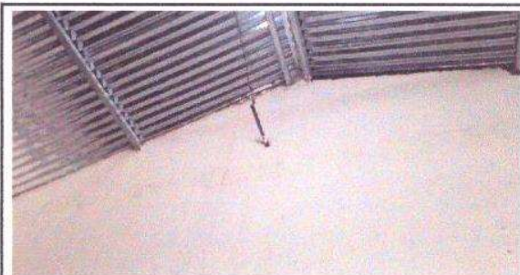
Foto 4: En estes salón tambien existe filtración de agua en las paredes.
