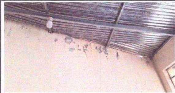
Foto 1: En esta foto se puede apreciar el la pintura depegada causada por la filtración de agua y la mala colocación del techo. Por lo que se desea solucionar ese problema.
