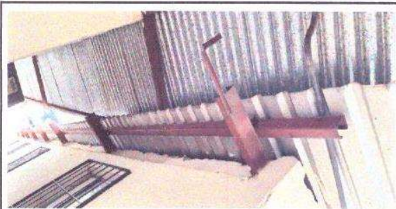
Foto 3: A la hora de las lluvias, las agua caen directamente a las puertas de los sanitarios por no tener canales para aguas.
