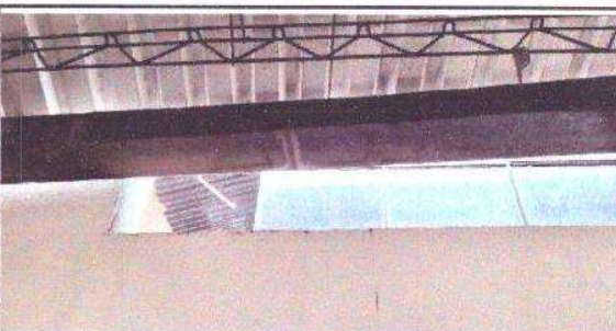
Foto 12: En esta foto se observa el canal viejo que existe y salpica todo el agua a la ventana del otro salón y filtra por las paredes.
