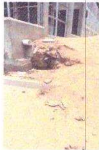
Foto 13: En esta foto se puede apreciar la entrada del módulo de párvulos llena de tierra y piedra.
