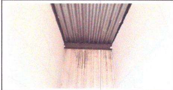
Foto 7: En esta se ve la filtración de agua en las paredes de los sanitarios por la mala colocación del techo.
