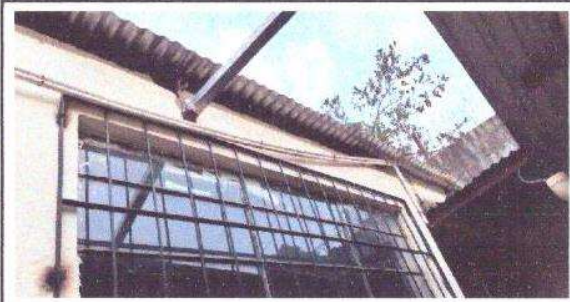
Foto 2: A la hora de llover el agua entra directamente en el salón, ya que esta totalmente descubierta.
