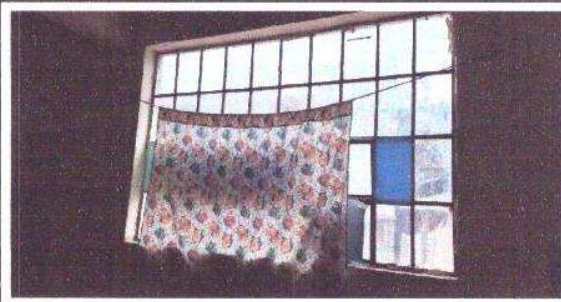
Foto 8: En esta foto se observa vidrios quebrados y el calor que almacena esta salón.
