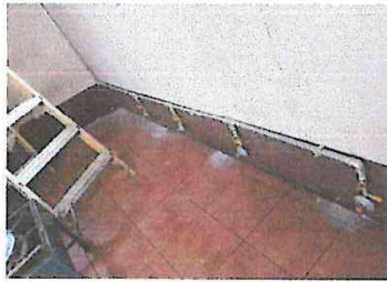
Foto 1: Sustitución por tanque de gas para el uso de estufas Industriales, ambiente de cocina
