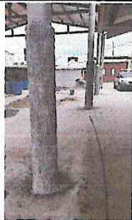
Foto 3: Mejoramiento de protección a bases, mantenimiento a estructura metálica de la cancha de basquet bool
