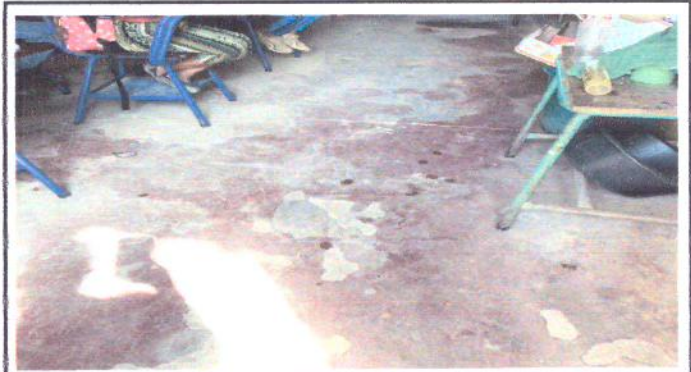
Foto 4: Modulo A: Piso deteriorado con agujeros.
