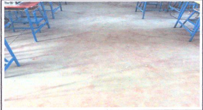
Foto 2: Modulo A: Piso en mal estado.
