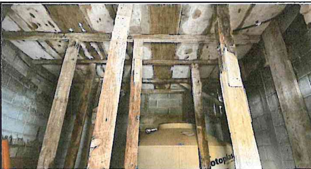
Foto 3: Modulo A: Finalización de abertura central y filtración de agua.
