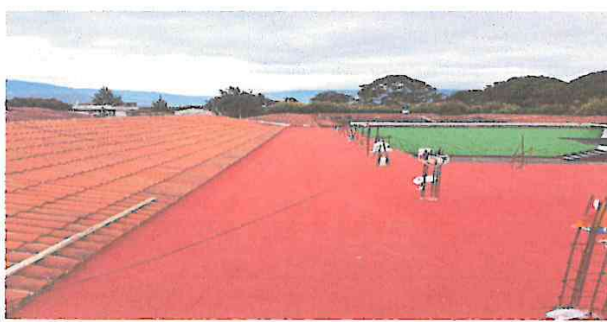
Foto 1: Terraza limpia y con sus bajadas de agua
