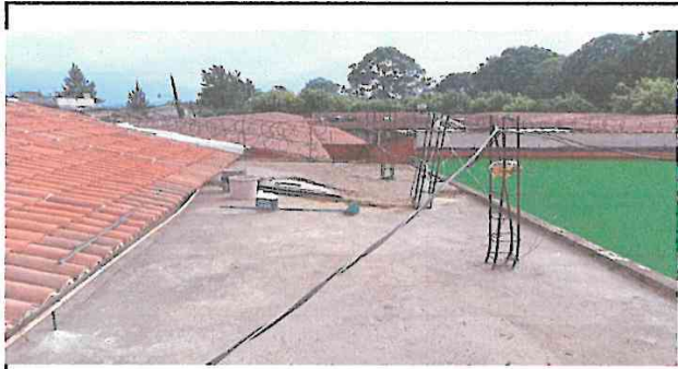
Foto 1: La terraza necesita nivelación de bajadas de agua
