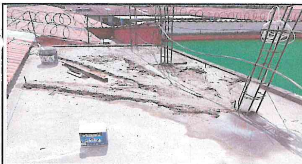
Foto 3: La terraza mantiene filtraciones de agua
