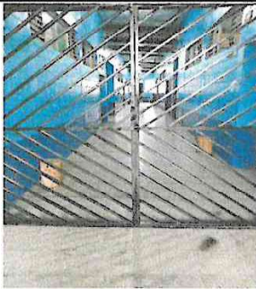
Foto 5: estado actual de las puertas de rejas
