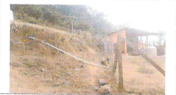
Foto 3: Se observa el limite actual de circulación, por lo cual, es necesario el muro perimetral.
