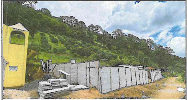
Foto 2: Se observa el avance del muro perimetral en toda la parte frontal de la escuela (de norte a sur) y una parte del costado izquierdo.
