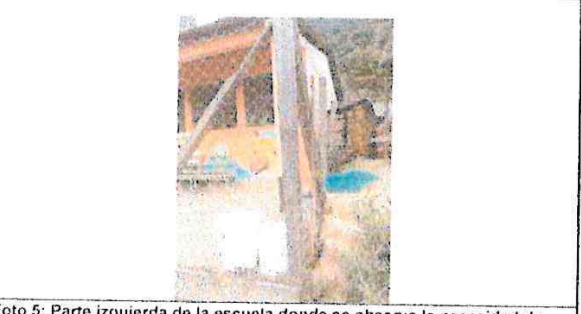
Foto 5: Parte izquierda de la escuela donde se observa la necesidad de instalar el muro perimetral para proteger el área del terreno.
