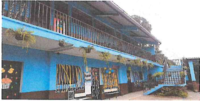
Foto 1: Baranda en mal estado
