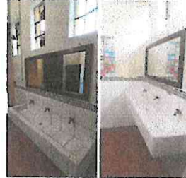
Foto 14: Suministro e instalación de dos espejos en servicios sanitarios de hombres y mujeres
