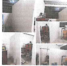
Foto 16: Suministro y reparación de muros con tablayeso para generación de cubículo en interiores de salón
