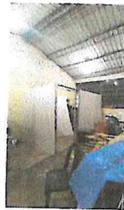
Foto 16: Suministro y reparación de muros con tablayeso para generación de cubículo en interiores de salón
