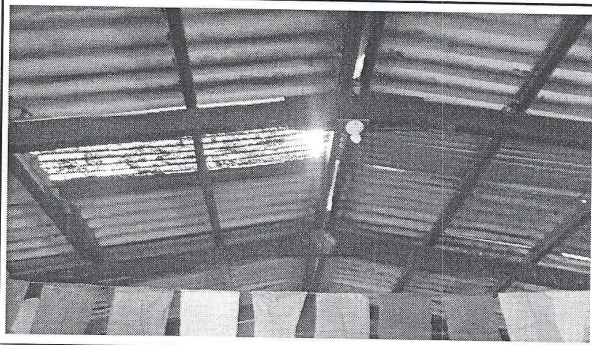
Foto 3: Imagen que muestra el estado actual del techo y la estructura portante de madera, del módulo de aulas a intervenir.
