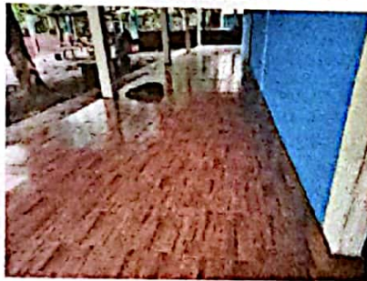
Foto 9: FOTOGRAFIA SUMINISTRO E INSTALACION DE PISO EN EL PASILLO, APLICACIÓN DE PINTURA EN EL EXTERIOR DEL AULA
