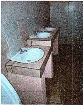
Foto 3: Sustrucción del lavamanos en mal estado.
