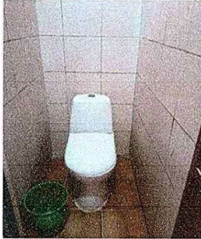
Foto 1: Sustrucción de los inodoros.
