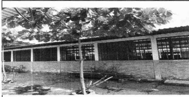
FOTO 13: Se observan las paredes sucias y sin pintura.
