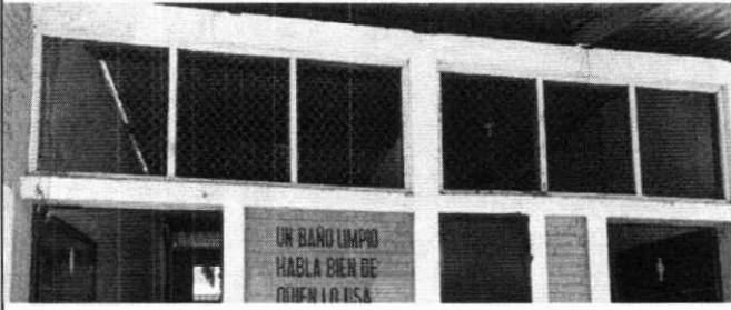
FOTO 7: Se observa que los balcones existentes no son funcionales, urge cambio a balcones de metal.
