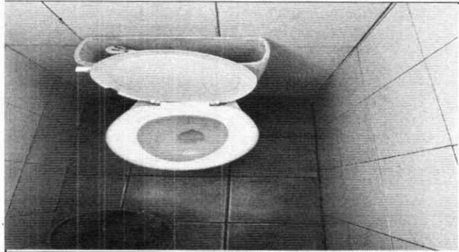
FOTO 1: Se observa el mal estado de los inodoros, urge sustitución.
