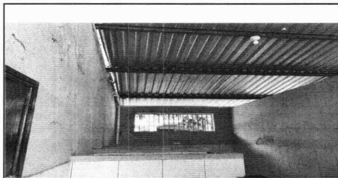
FOTO 5: Se observa las paredes sucias y sin pintura
