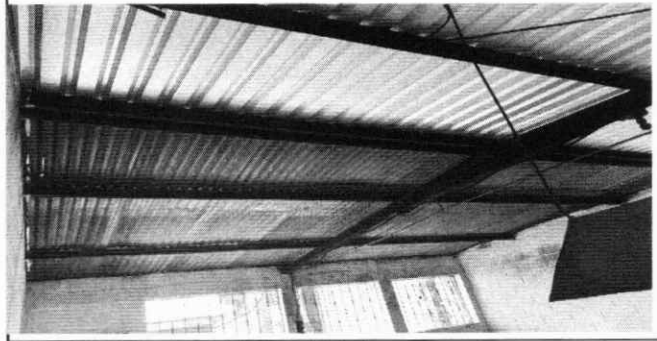
FOTO 8: Se observa el deterioro de láminas.
