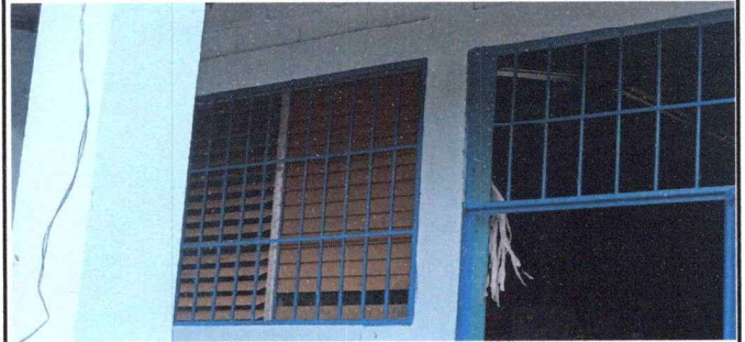
FOTO 10 MANTENIMIENTO DE BALCONES EN SALONES Y SANITARIOS LIJADO Y APLICADO DE PINTURA.
