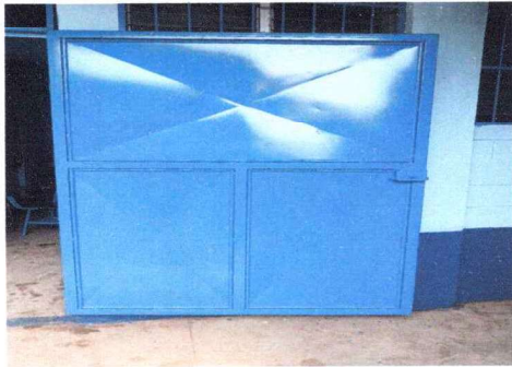
FOTO 9 MANTENIMIENTO DE PUERTAS DE METAL EN SALONES Y SANITARIOS , LIJADO CEPILLADO Y APLICADO DE PINTURA
