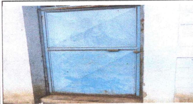
FOTO 9 MANTENIMIENTO DE PUERTAS DE METAL EN SALONES Y SANITARIOS , LIJADO CEPILLADO Y APLICADO DE PINTURA
