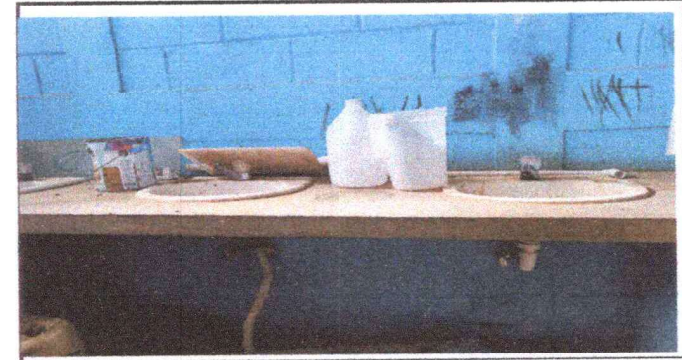
FOTO 6 REPARACIÓN DE LAVAMANOS INLCUYE CONTRALLAVE, TUBO DE ABASTO, SISTEMA HIDRAULICO Y SANITARIO EN BAÑOS DE HOMBRES Y MUJERES
