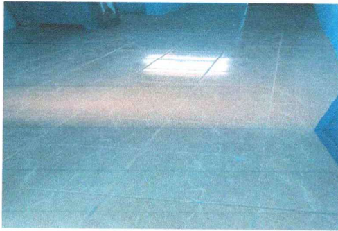
Foto 3: Sustrucción de piso cerámico.
