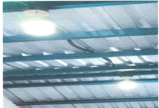
Foto 4: Sustrucción del sistema eléctrico.
