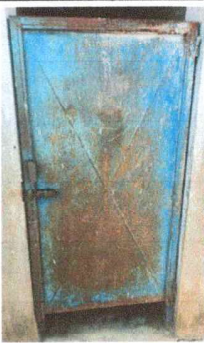
Foto 11: Se observan puertas en mal estado.
