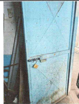
Foto 10: Se observan puertas en mal estado.
