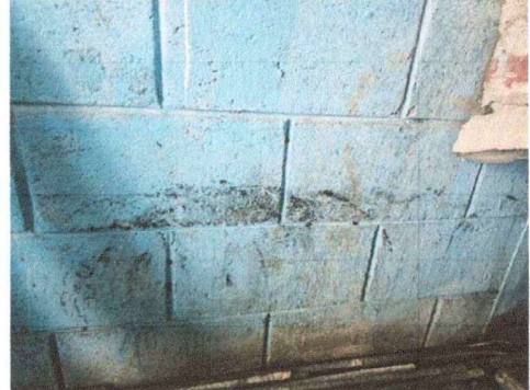
Foto 8: Se observan paredes manchadas.
