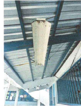
Foto 20: No se cuenta con luminarias.
