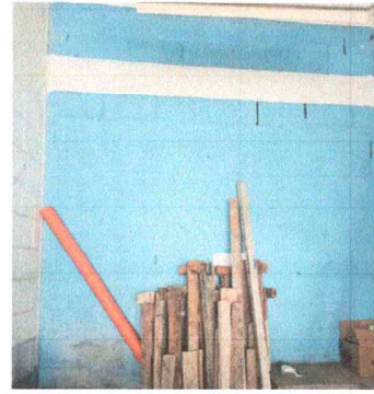
Foto 2: Se observa muro en mal estado.
