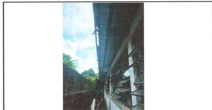
Foto 18: Se observa el canal de agua pluvial deteriorado.
