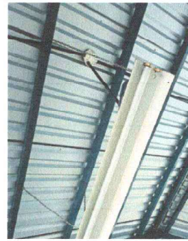
Foto 4: Se observa el sistema eléctrico en mal estado.
