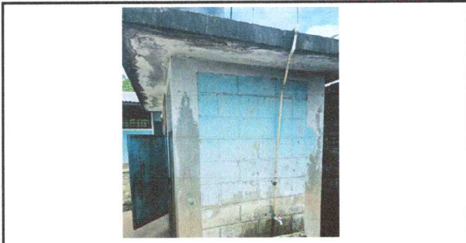
Foto 13: Se observa pintura en mal estado.
