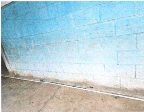
Foto 21: Se observa pintura en mal estado.
