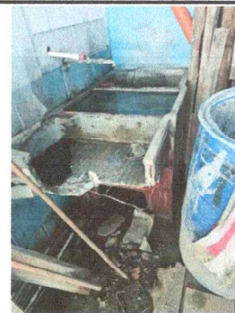
Foto 6: La pila se encuentra en mal estado.
