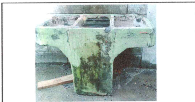
Foto 17: Se observa que no se cuenta con lavamanos.
