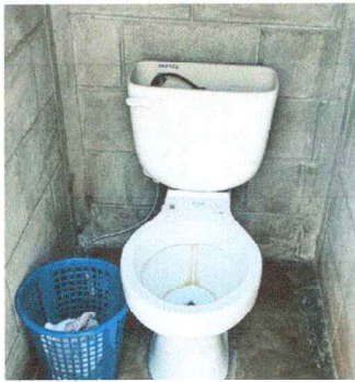
Foto 9: Se observa inodoros en mal estado.
