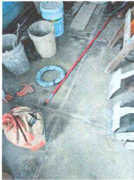
Foto 3: Se observa que no se cuenta con piso cerámico.
