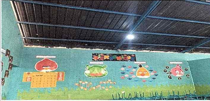
FOTO 1: Se observa el mal estado de las laminas del modulo 1.
