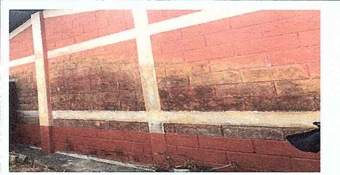
FOTO 5: Se observa la falta de cernido en muro
