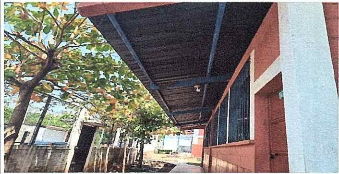
FOTO 3: Se observa la falta de canal de agua en el modulo 1.
