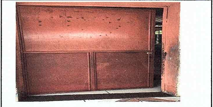
FOTO 6: Se observa el oxido y mal estado de las puertas.
