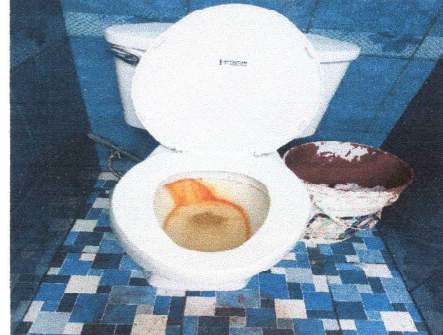
Foto 8: Accesorios de sanitario, por deterioro y fuga de agua.
