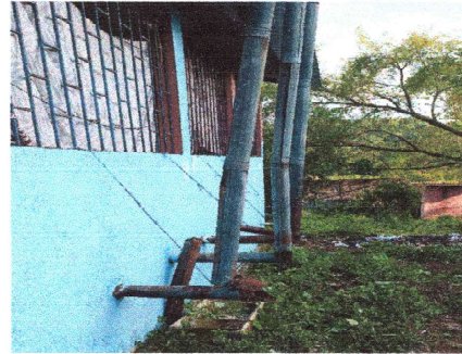
Foto 4: Se observa chimeneas de cocina en mal estado.
