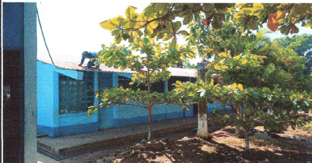
Foto 1: Se observa el mal estado de la lámina de las aulas de párvulos, urge mantenimiento.
