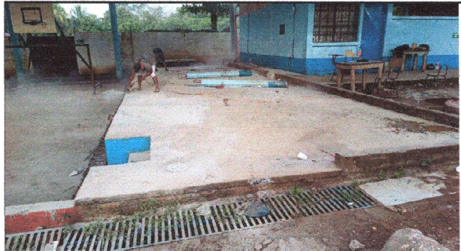
Foto 2: Se observa el deterioro del piso de cemento de escenario.
