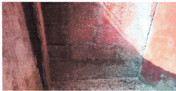
Foto 5: Se observa la necesidad de implementar salida de agua.
