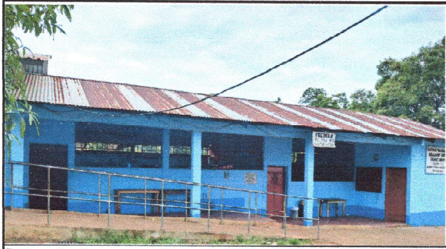
Foto 1: Se observa que la lámina de zinc, se encuentra en mal estado
