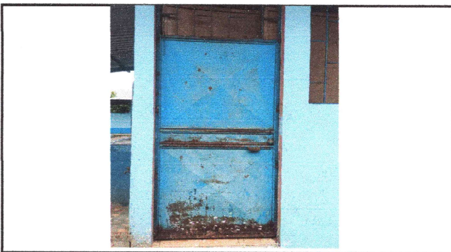
Foto 4: Se observa puertas en mal estado (cocina)
