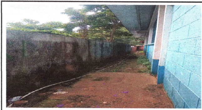
Foto 3: Se observa acumulación de agua y filtración a aulas de párvulos. Banqueta
