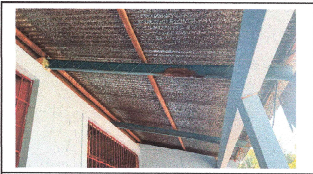
Foto 2: Se observa mal estado de la estructura metálica
